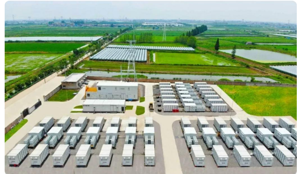
Sistema de almacenamiento estacionario Na-ion en China
